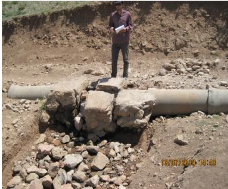
شکستگی منهول موجود در مسیر خط لوله انتقال اب در مسیر مابین بند سعید آباد تا روستای نوچه ده
